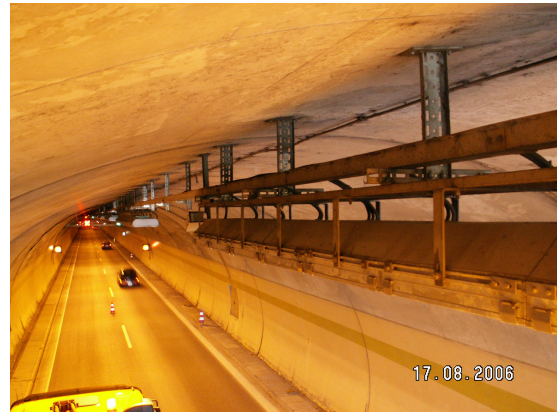
Leuchtentragkonstruktion Hohentwiel隧nells
