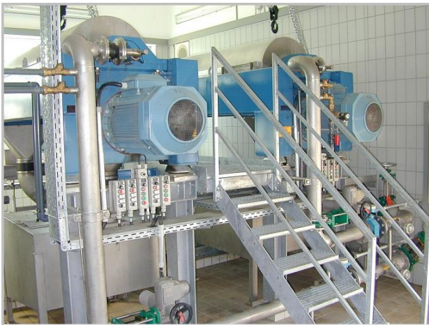
Dekanter für die Überschussschlammdeindickung
