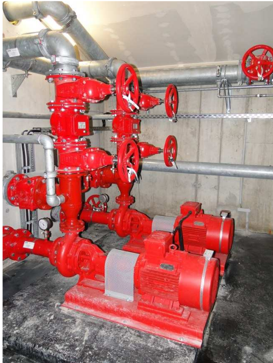
Sprinklerpumpen, Hohenstaufenhalle Göppingen, Umbau, Sanierung, Erweiterung
