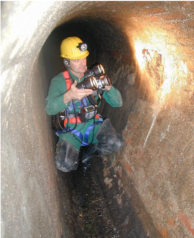
Ausleuchtung des Schadens
