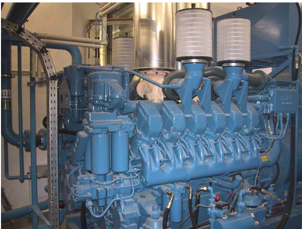
Notstromaggregat des Klinikums Bad Salzungen
